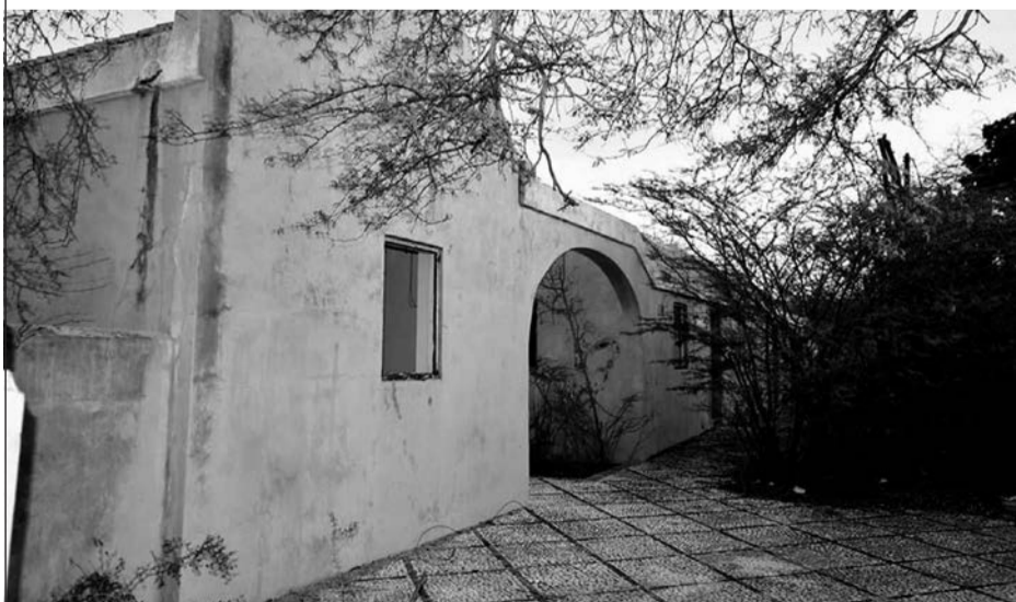
E fotonan aki di ruina di e edifisio na Karpata ta di Rudolf Wout, kende ta pidi ousilio pa nan.
